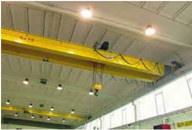
Gru a Ponte (Carroponte)
